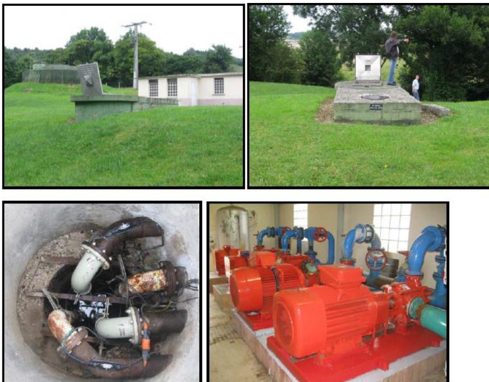
Figure 15 : Tête de puits et accès à la tête de puits du captage de Villy sur Yères (Source : Document 1)
